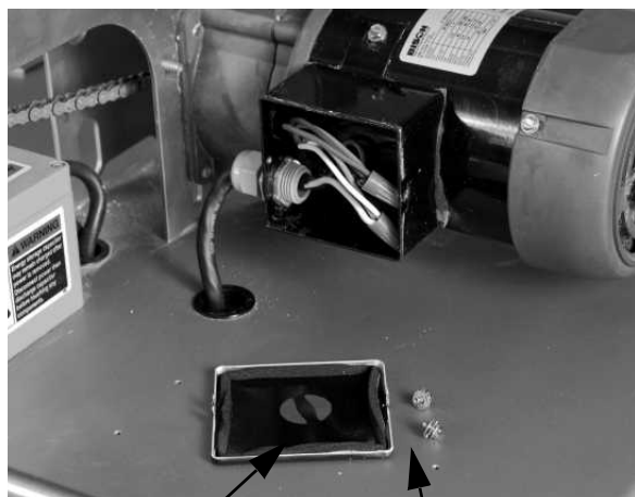
Cubierta de la caja de conexiones
